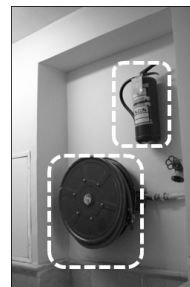
تصویر ۹: لوازم اطفای حریق با اتصالات نامناسب
