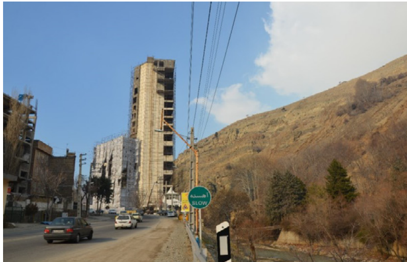
(شکل شماره ۵) ساخت و ساز غیراصولی و کاربری (هتل سازی) نایم در بستر رودخانه در جاده روستای رودک
