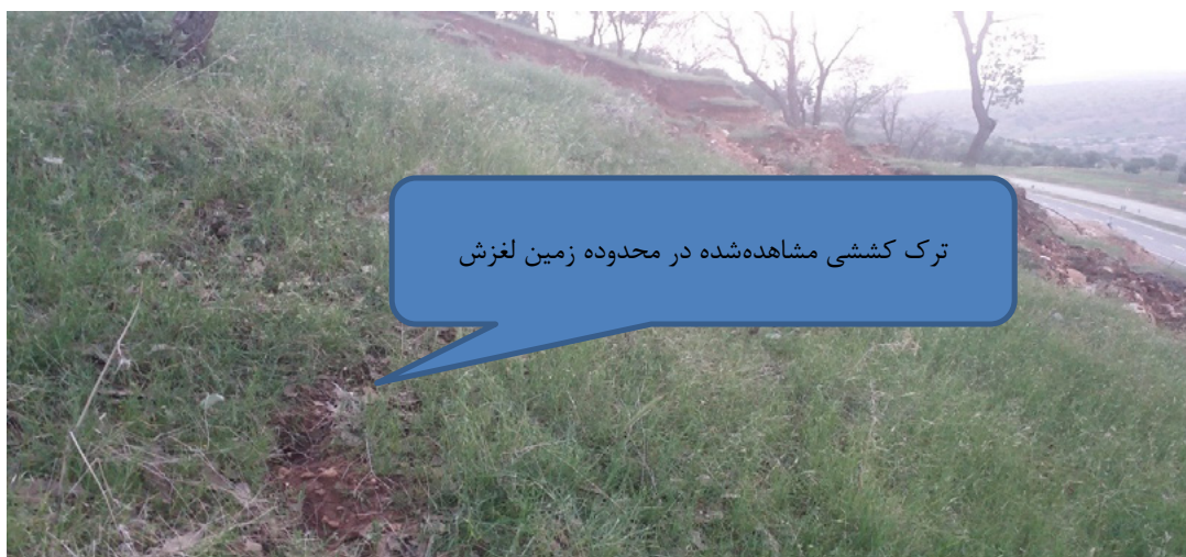
شکل ۱۲- ترک‌های کششی مشاهده شده در محدوده ترانشه
