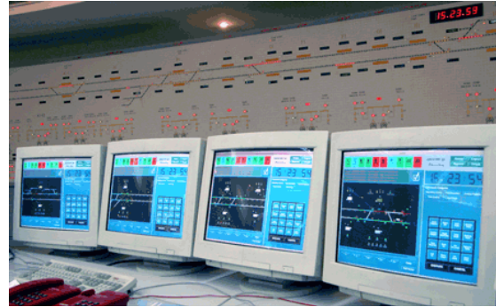
تصویر ۵: نمایی از اتاق واپایش ایستگاه قطار
