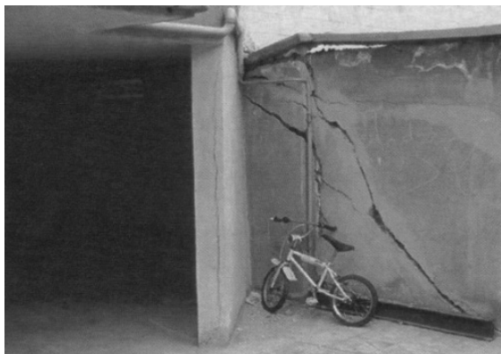
تصویر شماره ۵: نشست زمین و آسیب دیدگی ساختمان‌های نوساز در جنوب میدان فتح (منطقه ۹)، [۱۲]
