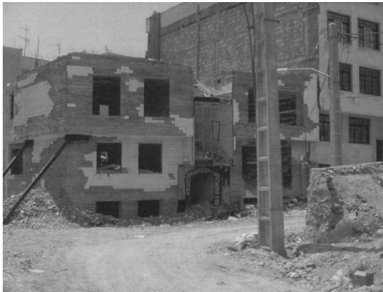
تصویر شماره‌ی (۳): ایجاد ترک و بروز آسیب‌های شدید در ساختمان‌های کوی کارکنان مجلس، [۱۲]
