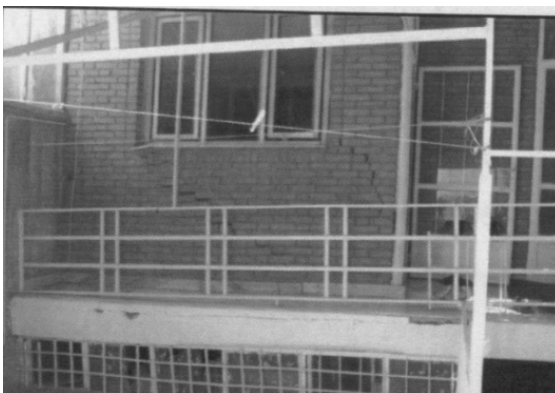
تصویر شماره ۴: نشست زمین و آسیب دیدگی شدید ساختمان در اثر ریزش انباری چاه‌های دفع فاضلاب محدوده خیابان دامپزشکی (منطقه ۹)، [۱۲]
