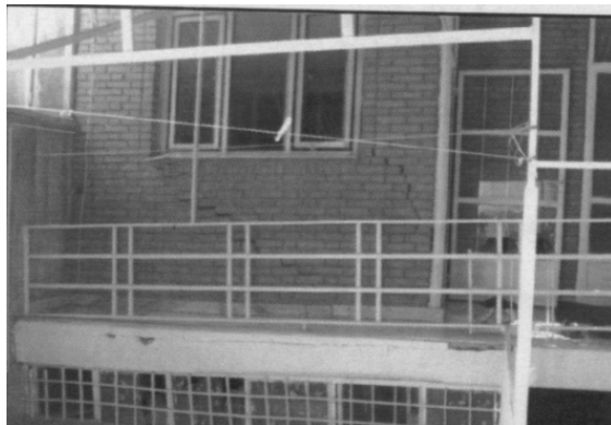
تصویر شماره ۴ (۴): نشست زمین و آسیب دیدگی شدید ساختمان در اثر ریزش انباری چاه‌های دفع فاضلاب محدوده‌ی خیابان دامپزشکی (منطقه ۹)، [۱۲]
